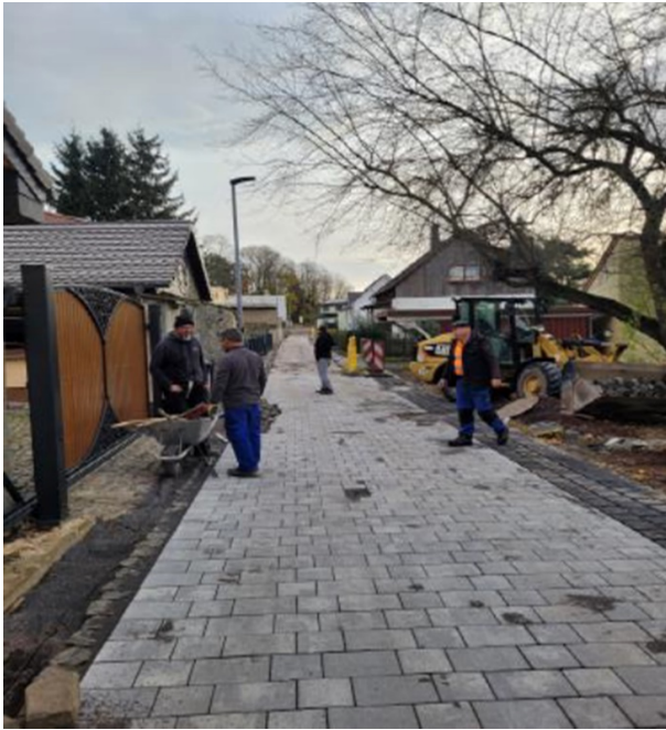
Bild 2: Radwegebau in Seegeritz, die alten Kopfsteinpflaster werden am Wegrand mitgenutzt. Quelle: Stadt Taucha
